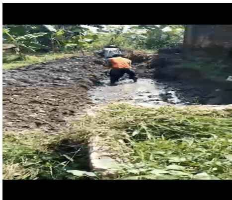
Gambar 4. Bak Buangan Limbah Cair Sebelum di perbaiki
