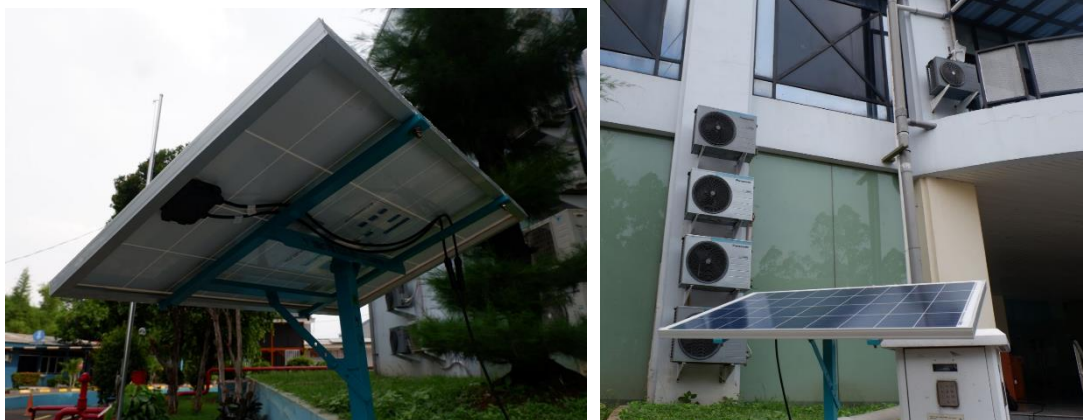
Gambar 8. Komponen Panel Surya Terpasang
